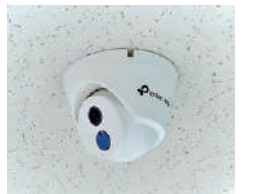
防犯カメラ 患者さんに安心して過ごしていただけるように、防犯カメラを設置しました。
