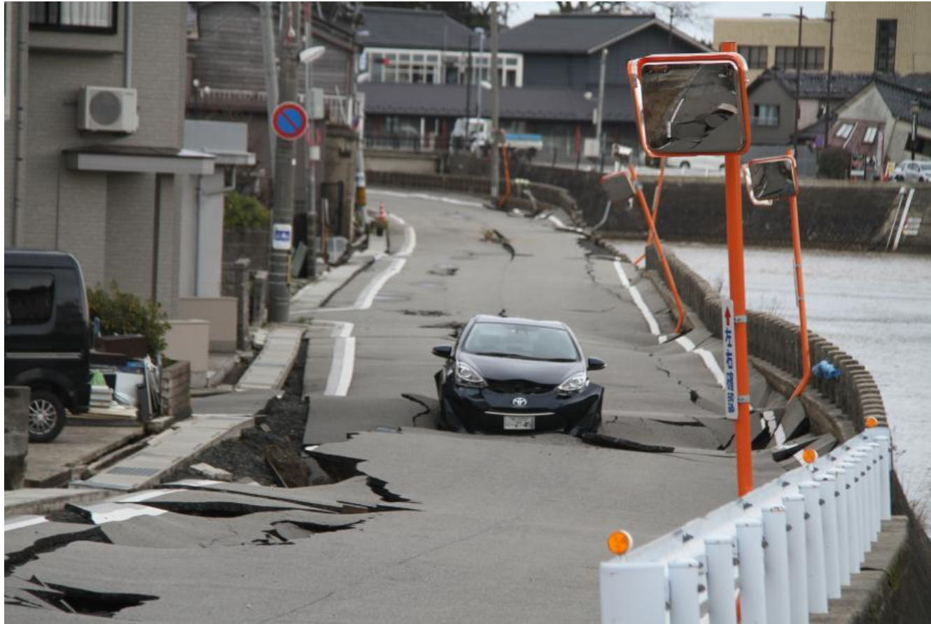
液状化で道路が陥没（石川県ホームページから）
