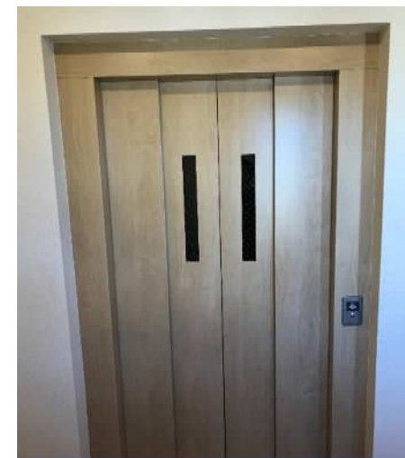
エレベーター
