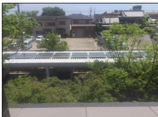
公共施設太陽光発電設備（市役所）
