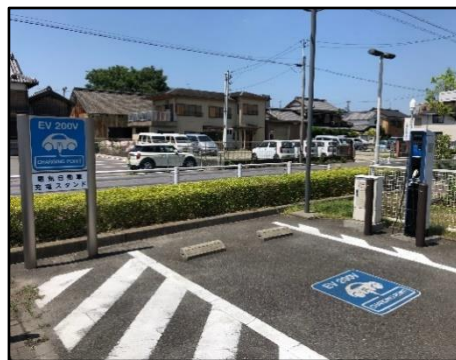
碧南市役所東駐車場 充電スタンド
