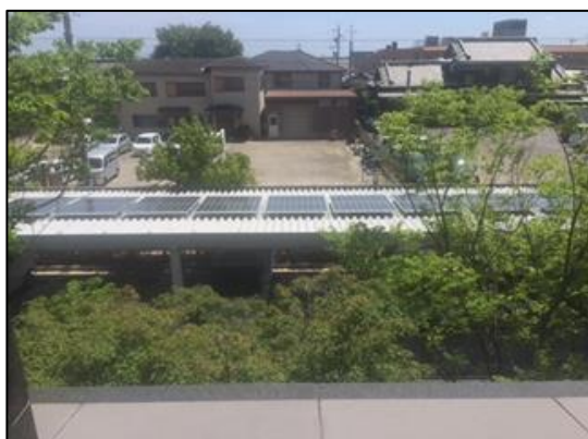
公共施設太陽光発電設備(市役所)
