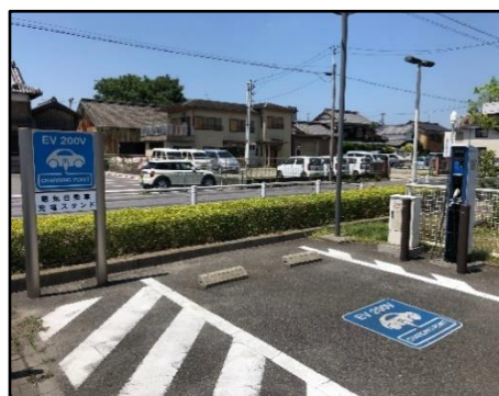
碧南市役所東駐車場 充電スタンド
