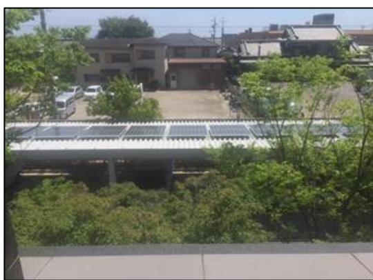
公共施設太陽光発電設備(市役所)
