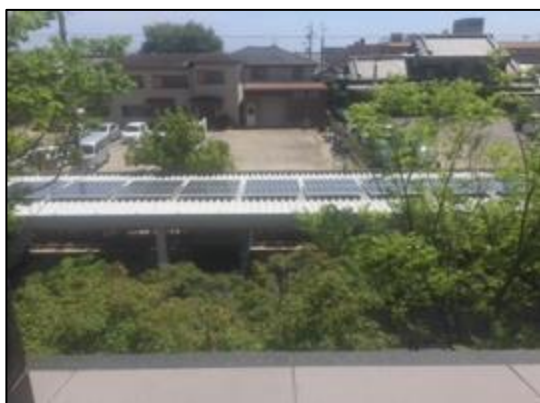
公共施設太陽光発電設備(市役所)
