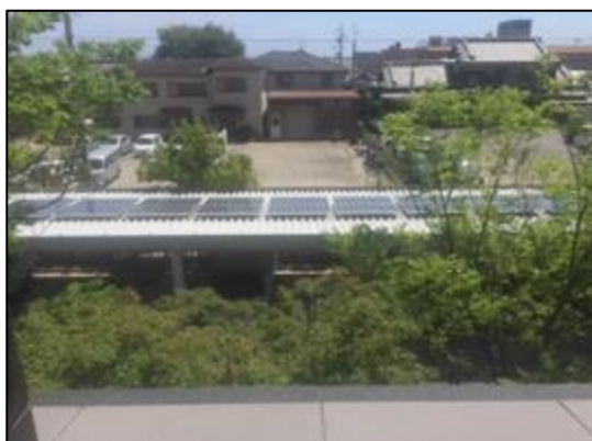
公共施設太陽光発電設備（市役所）
