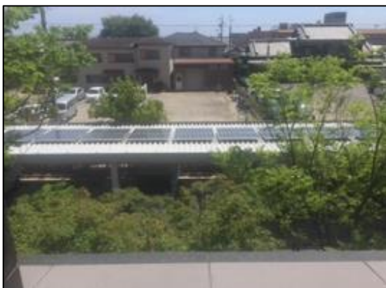
公共施設太陽光発電設備(市役所)
