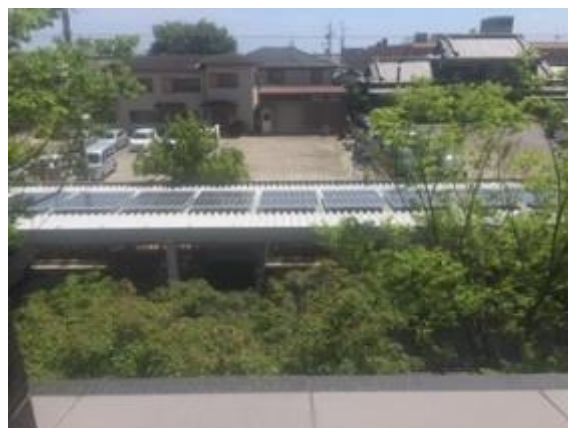
太陽光発電システム
