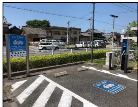
碧南市役所東駐車場 充電スタンド
