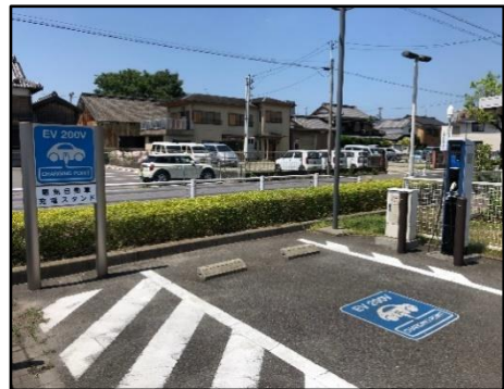
碧南市役所東駐車場 充電スタンド
