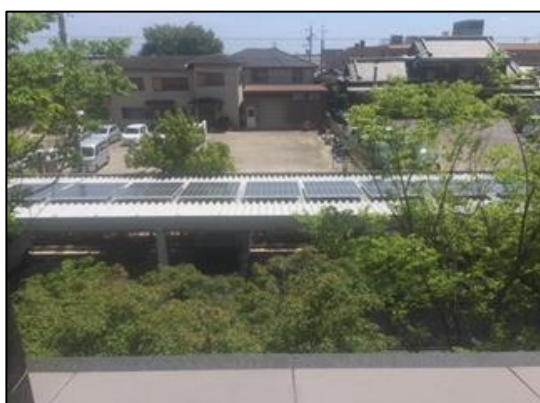
公共施設太陽光発電設備(市役所)
