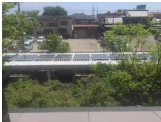
太陽光発電システム
