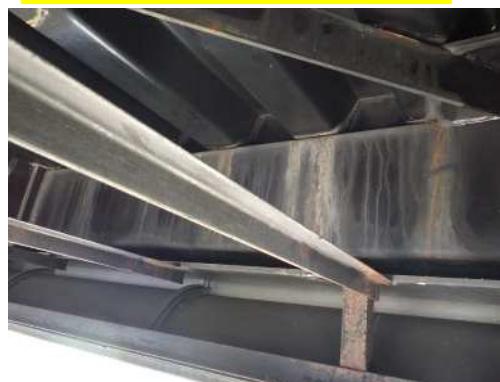
②横桁：遊離石灰、漏水跡
