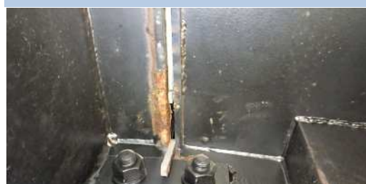
③損傷原因：伸縮装置の劣化
