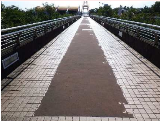
舗装：舗装の異常（うき）
