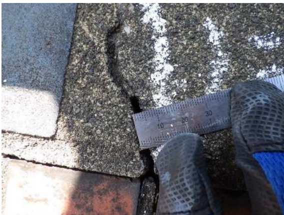
①②基礎：ひびわれ（ひびわれ幅W=3.0mm）
