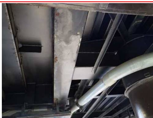
①横桁：腐食、防食機能の劣化
