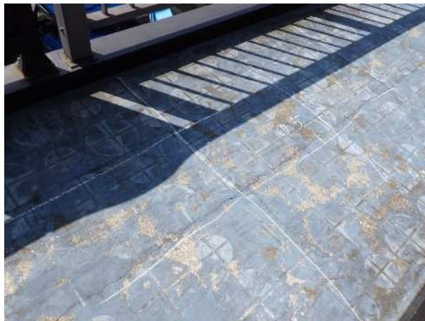
③直上の橋面舗装：橋面全体のひびわれ
