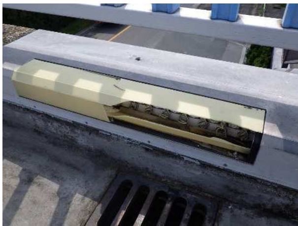
照明カバー：欠損
