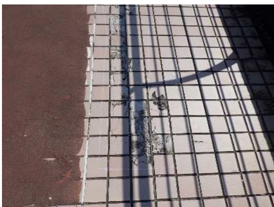
舗装：舗装の異常（剥離）
