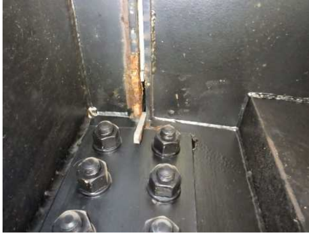
伸縮装置：欠損
