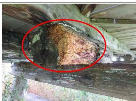
< 腐朽（健全性 II __対策区分 C1）>
