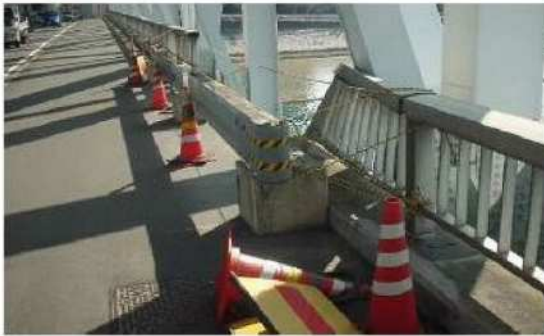
防護柵の破断事例
