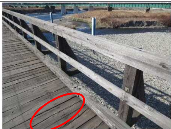
床版の上面にわれが生じている。
