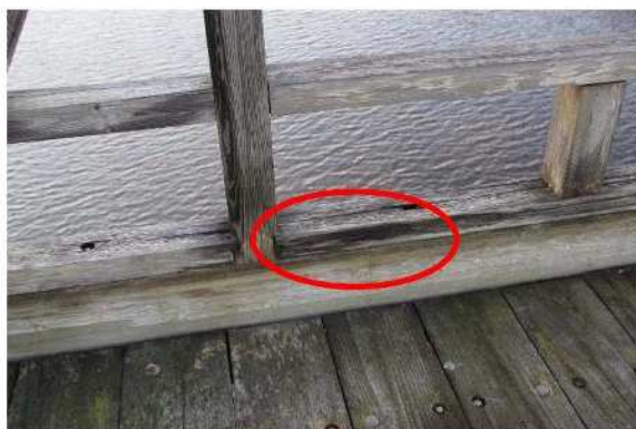
< 腐朽（健全性 I __対策区分 B）>
