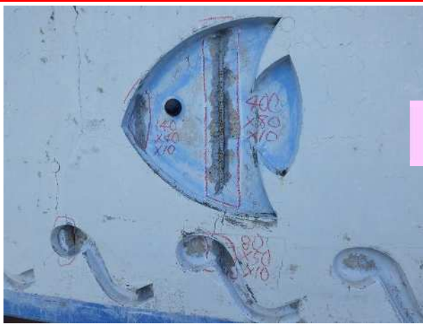
写真①__鉄筋露出
