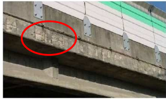
コンクリート片の剥落（第三者被害の懸念）事例
