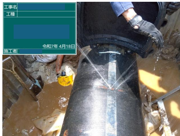
老朽管からの漏水
