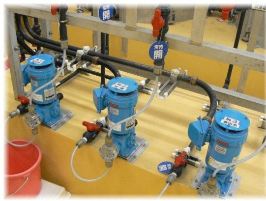
塩素注入ポンプ（第2配水場）
