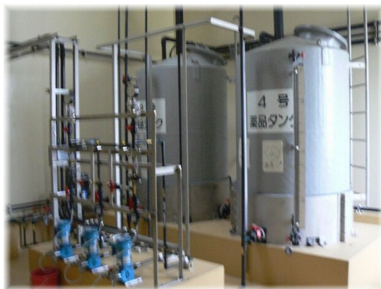
塩素貯留タンク（第2配水場）
