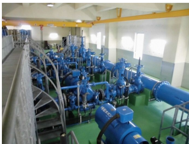
第2配水場 ポンプ設備
