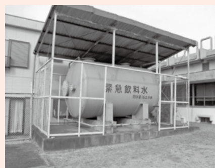
△旭町にある第1配水場の応急給水栓（蛇口付）
