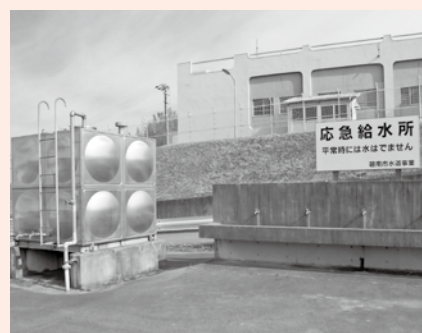
△二本木町にある第2配水場の応急給水栓（蛇口付）
