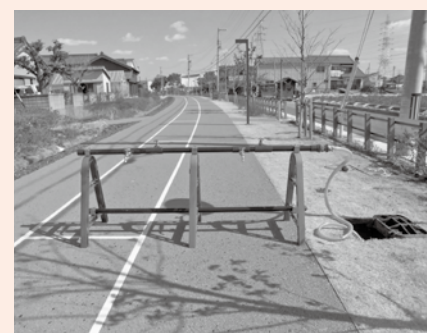
△第2配水場と栗山防災倉庫に保管されている資材を組立設置した仮設給水施設
