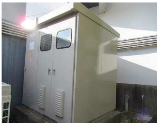
高圧受電設備
