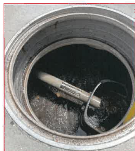
1槽目の中の状態
