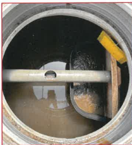
2槽目の中の状態
