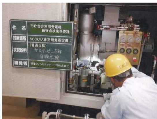
非常用発電機保守点検業務
