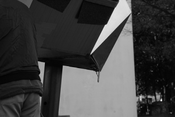
接続不良部分
