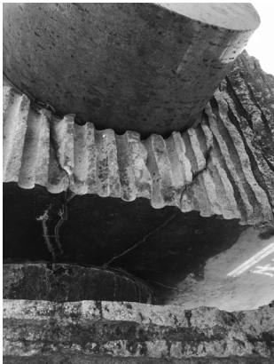
亀裂のようす
