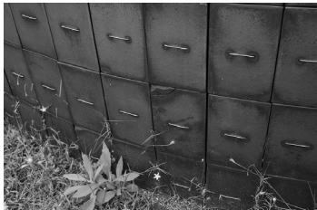
部分(瓦)の欠損例
