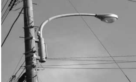
道路照明灯(電柱共架型)
