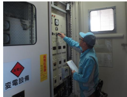
【電気設備の定期点検】
