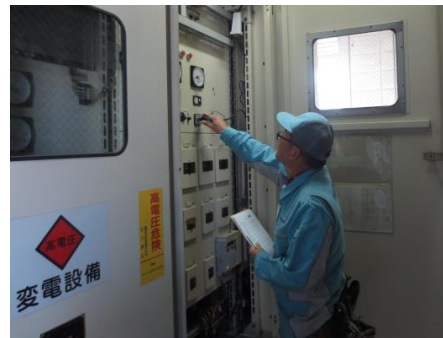
【電気設備の定期点検】
